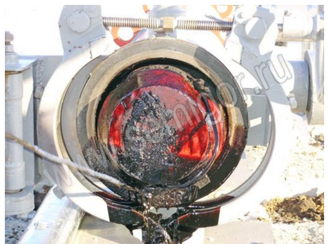
Поролоновый очистной поршень Семигор-ЛС-219 в камере приема. На корпусе поршня металлическая проволока из нефтепровода.
