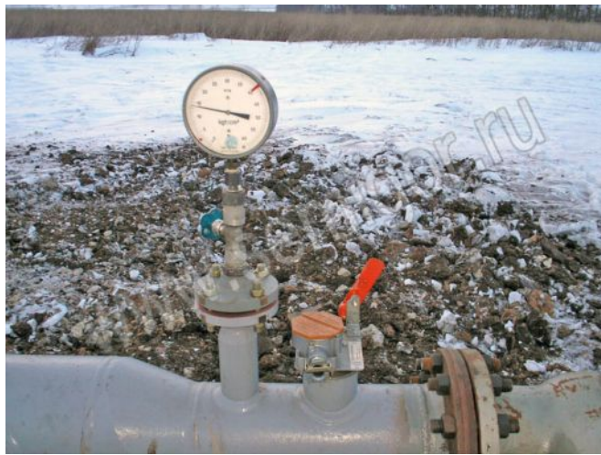
Камера приема очистных поршней. Сигнализатор прохождения поршня зафиксировал приход поршня в камеру.
